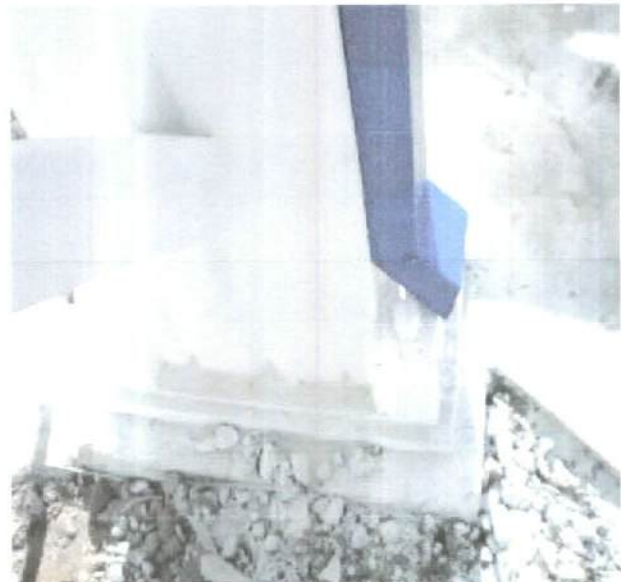
Fotografía N°46: Vista de inexistencia de drenaje para la evacuación de las aguas lluvias.
