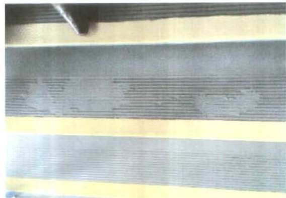
Fotografía N° 71: Detalle peldaño con estoperoles estriados y desgastados.
