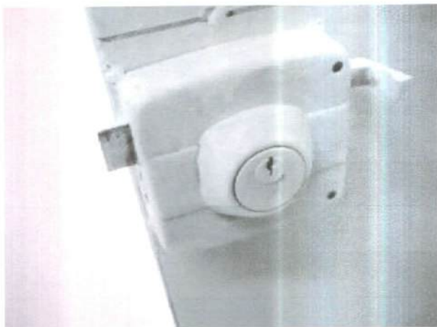
Fotografía N°40. Vista de chapa de puerta que no contempla ser pintada.
