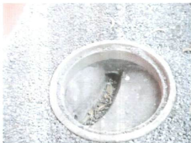
Fotografía N°35: Vista del sistema sin protección.
