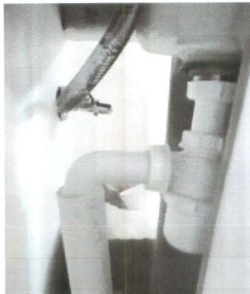
Fotografía N° 85: Detalle de otro sifón de PVC instalado en la evacuación del lavamanos.
