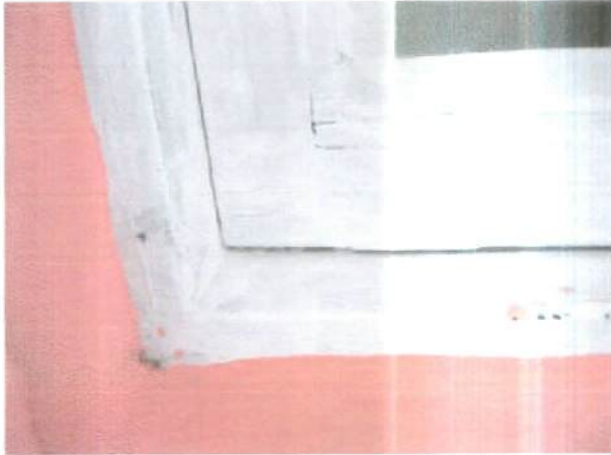
Fotografía N°36: Vista de deficiencia en la ejecución de la pintura.
