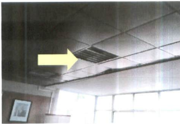
Fotografía N° 70: Vista de placa de cielo no apoyada sobre completamente sobre perfil especificado.
