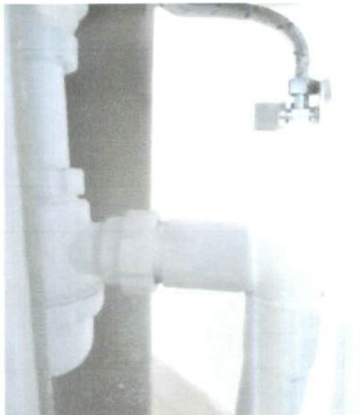
Fotografía N° 84: Vista del sifón de PVC blanco y la llave de corte metálica cromada.
