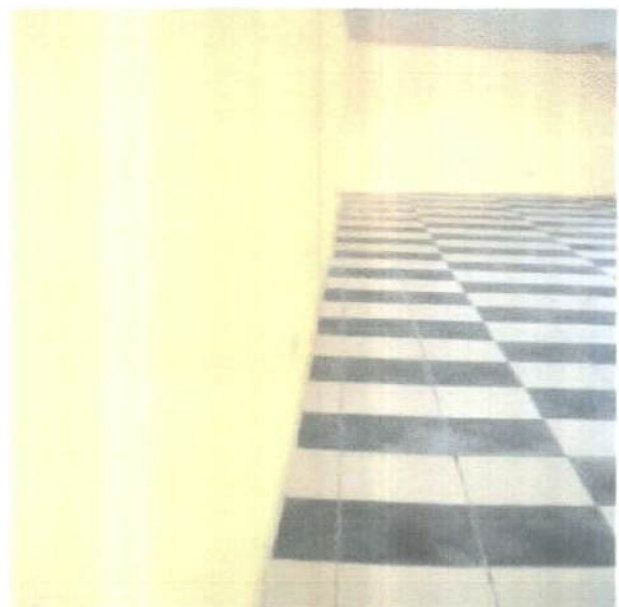
Fotografía N°25: Vista de muro desaplomado.
