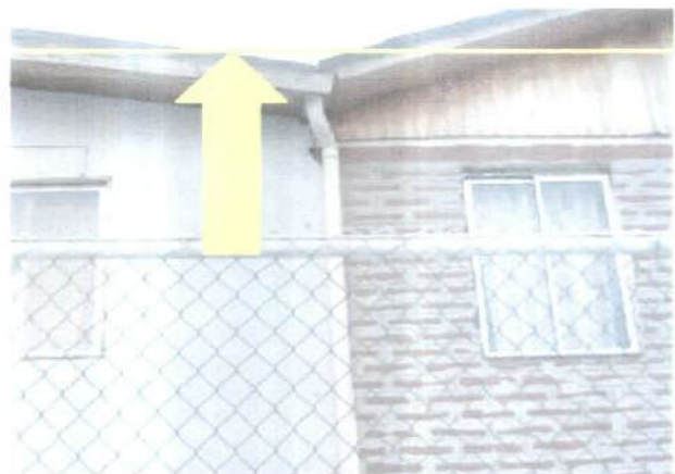
Fotografía N° 15: Vista de altura de cierre insuficiente.
