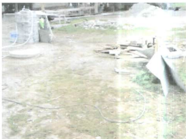
Fotografía N° 34: Vista del insuficiente orden en las faenas.
